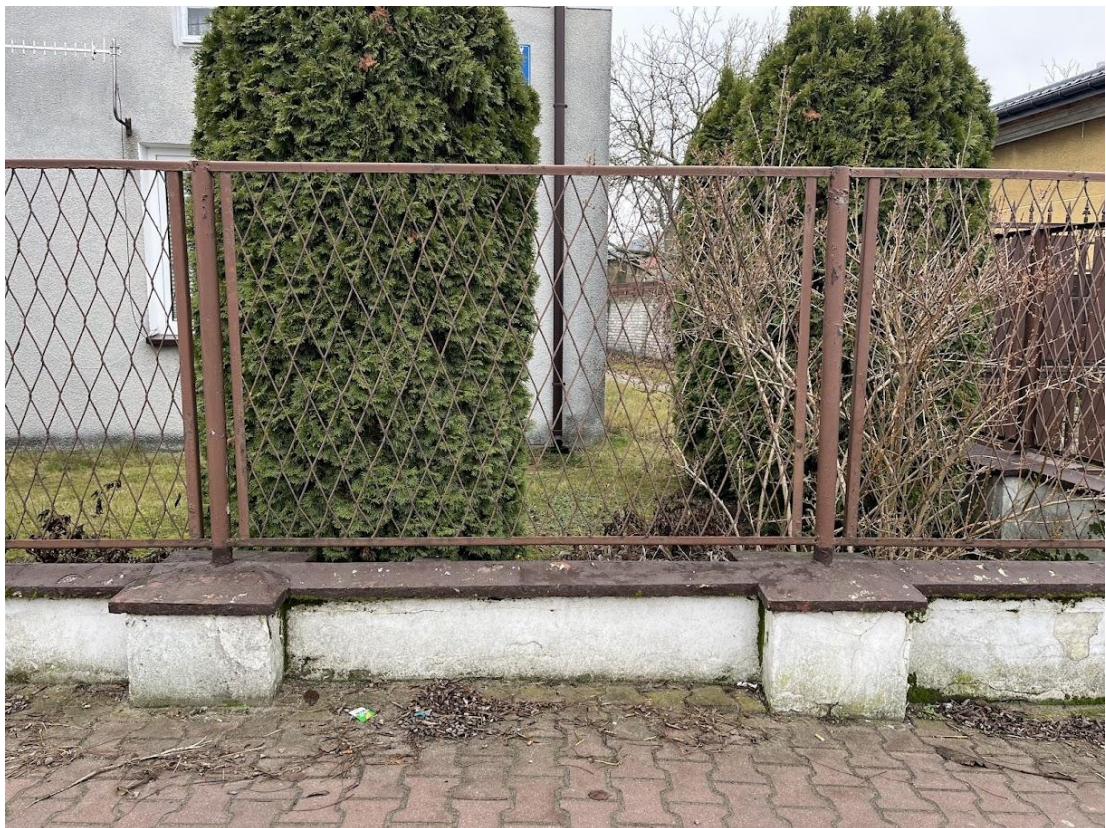
Fot. 2.2-6 Ogrodzenie ażurowe stalowe
